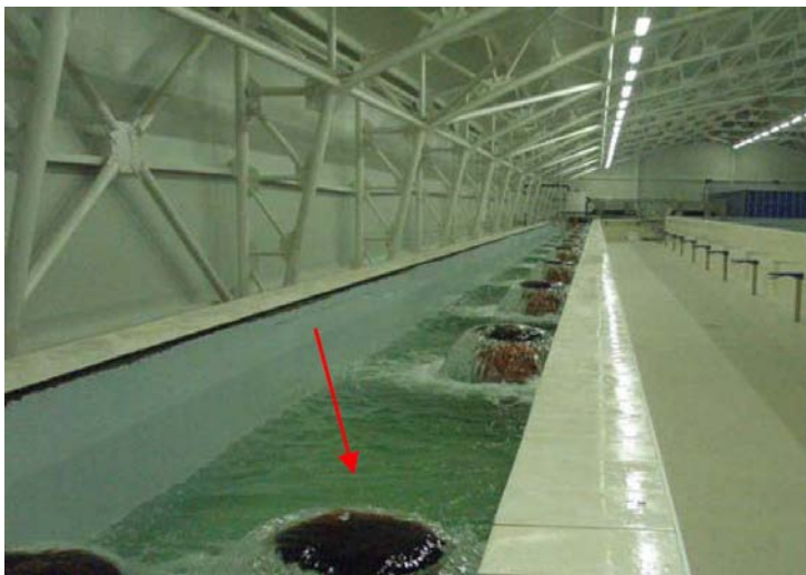
Рис. 21. Лоток сбора воды открытого типа (бетон). Стрелкой указан телескопический слив совместно и контроль уровня воды в бассейне
