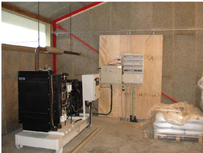
Рис. 9. Щитовая и резервный генератор. Общее потребление энергии – 20–30 кВт. Основная плата и резервный генератор, общее потребление энергии – 20–30 кВт
