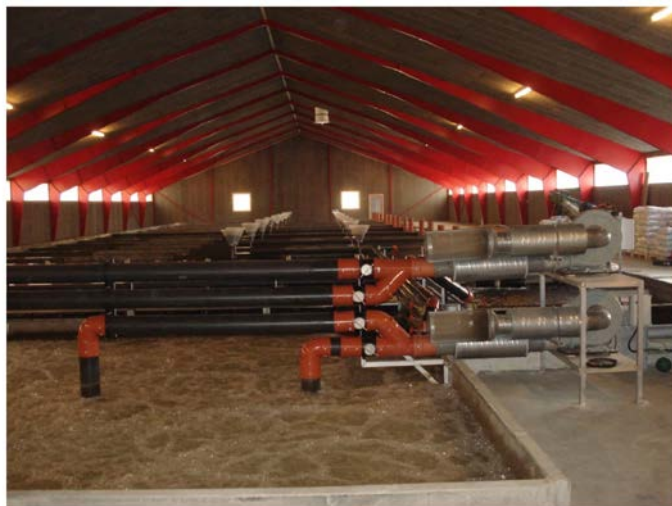
Рис. 14. Дегазатор, оснащенный воздуховкой VENTUR и системами трубопроводов
