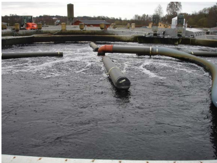
Рис. 7. Биофильтр и подающий воздух трубопровод
