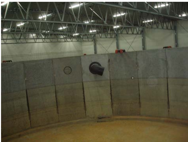
Рис. 32. Вид изнутри на производственный бассейн (Danish salmon, Хиртсшальс, Дания)
